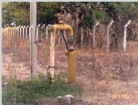
Figura 8 - Manancial subterrâneo sem a infra-estrutura adequada
