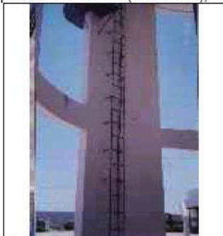
Foto 10 – Vista do reservatório R1 com escada externa de acesso sem gaiola de proteção
