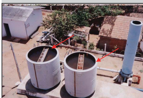
Antes: Filtros ascendentes sem tampas de proteção (fiscalização inicial em 15 e 16 de setembro/2004)
