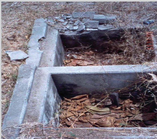
Figura 19 - Ponto de descarga de rede
