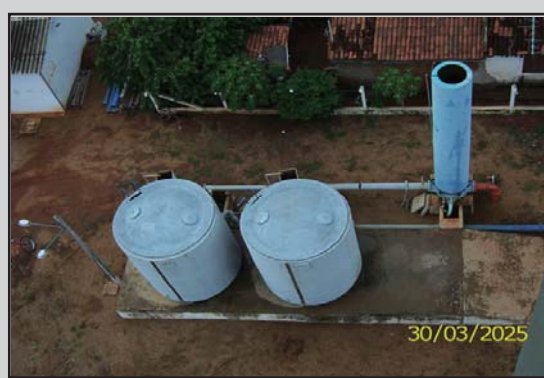
Depois: Filtros ascendentes com tampas de proteção (fiscalização de acompanhamento em 30 e 31 de março/2005)
