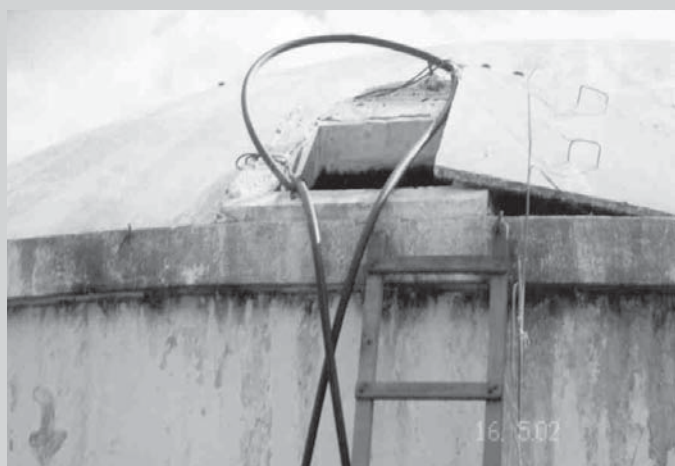
Figura 6 - Não-conformidade caracterizada pela tampa de reservatório fora do lugar
