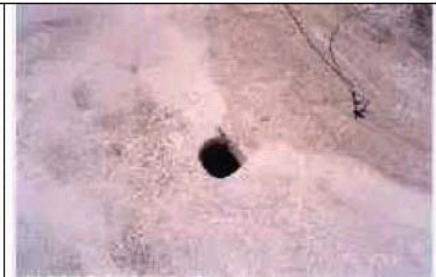
Foto 9 – Buraco na laje da cobertura do reservatório R2 funcionando como ventilação
