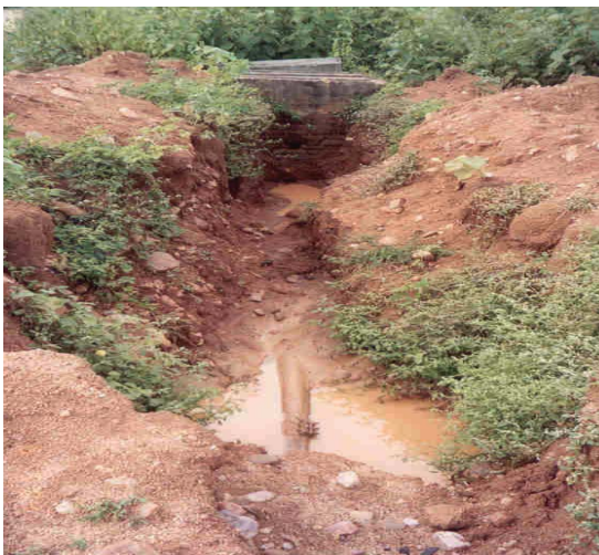
Figura 12 - Vazamento em adutora
