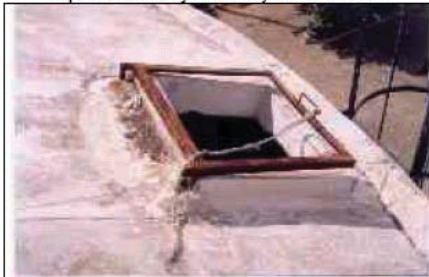
Foto 8 – Abertura de inspeção do reservatório R2 sem tampa
