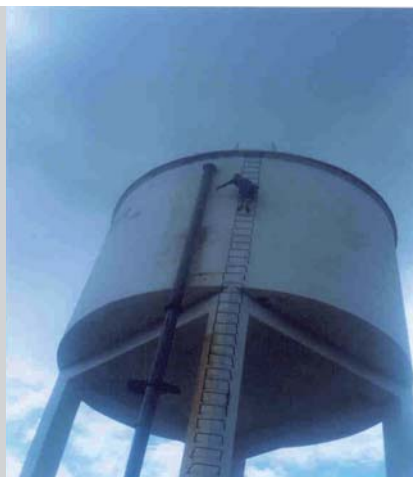
Figura 17 - Reservatórios com escada sem gaiola de proteção
