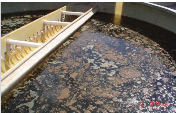
Figura 13 - Formação de lodos e bolhas no processo de filtração
