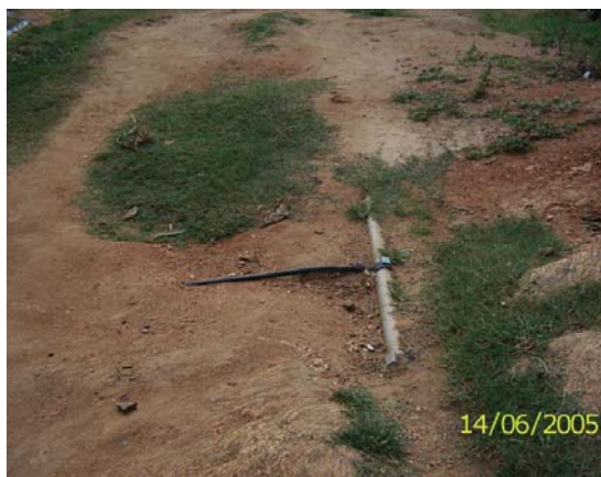
Figura 21 - Rede e ramal de ligação expostos
