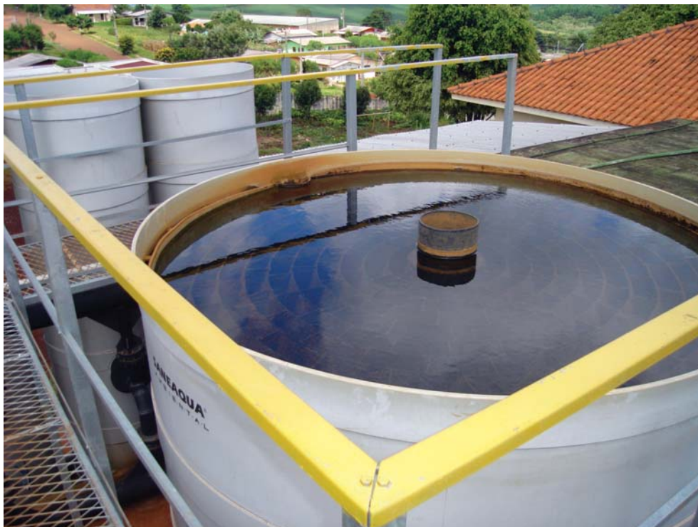
Filtros da ETA - Porto Barreiro, PR FOTO Marcelo Stedele | Banco de Imagens Cobrape
