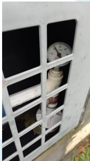
Figura 6 - Manômetro instalado em um cavalete de água para realização do monitoramento da pressão na rede de abastecimento.
