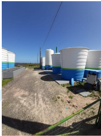
Figura 5 - Estação de Tratamento de Água (ETA) Esplanada.
