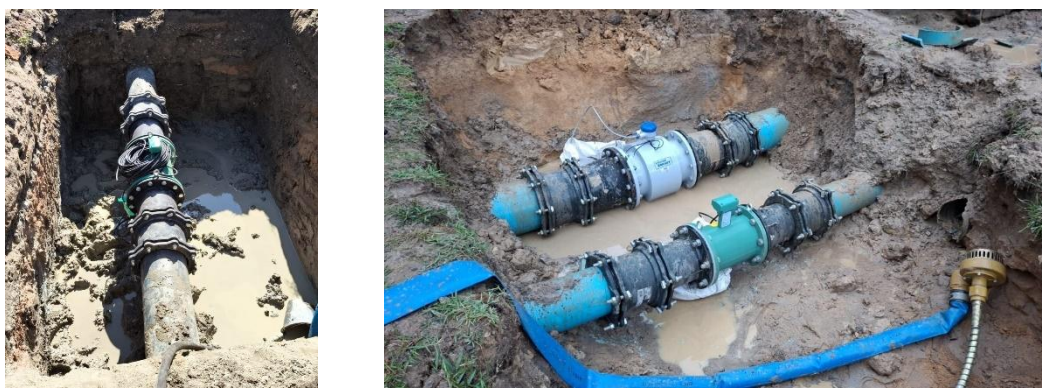
Figura 8: Instalação dos macromedidores de água bruta instalados no Rita e Laranjeiras
