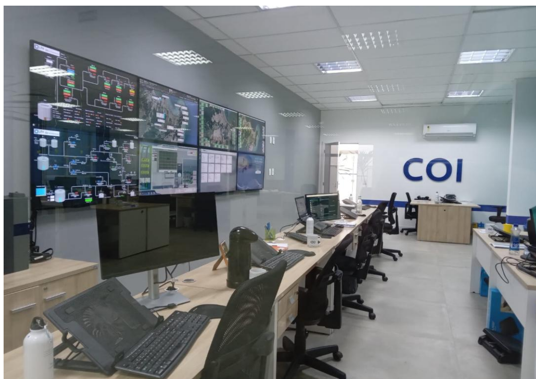
Figura 03: Sala de Centro de Controle Operacional
