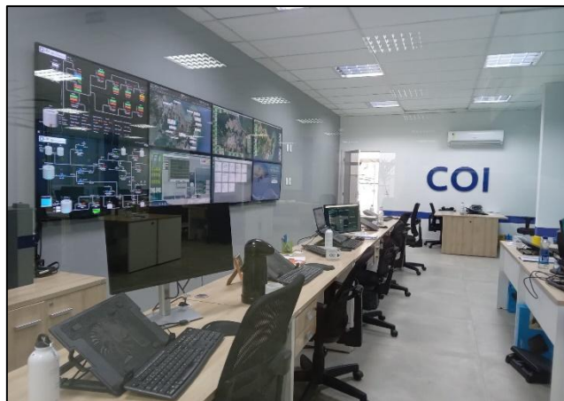
Figura 4 - Sala de Centro de Operações Integradas.
