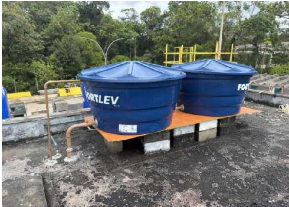
Figura 27 - Reservação de água filtrada
