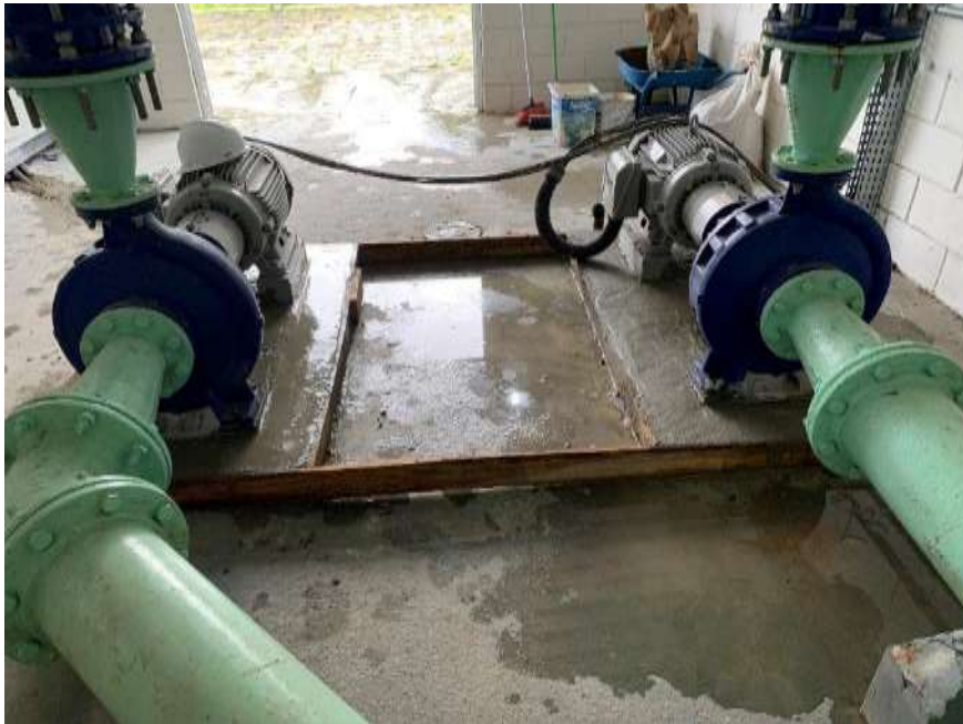
Figura 20 -Booster Pontal com dois conjuntos motobombas de 50 cv
