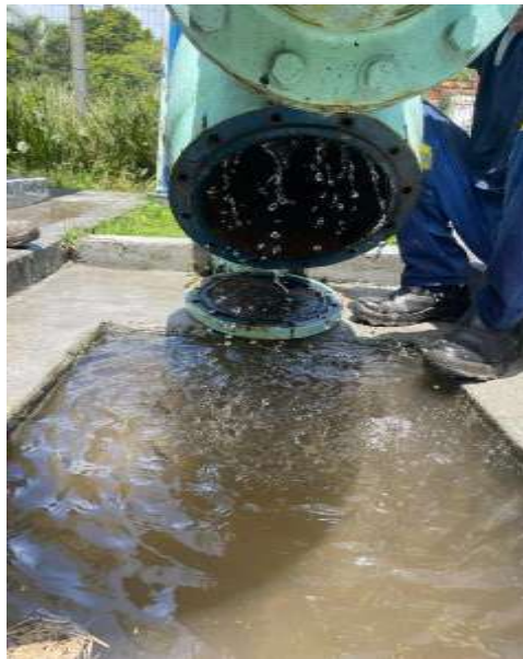
Figura 26 - Limpeza de filtro dos boosters
