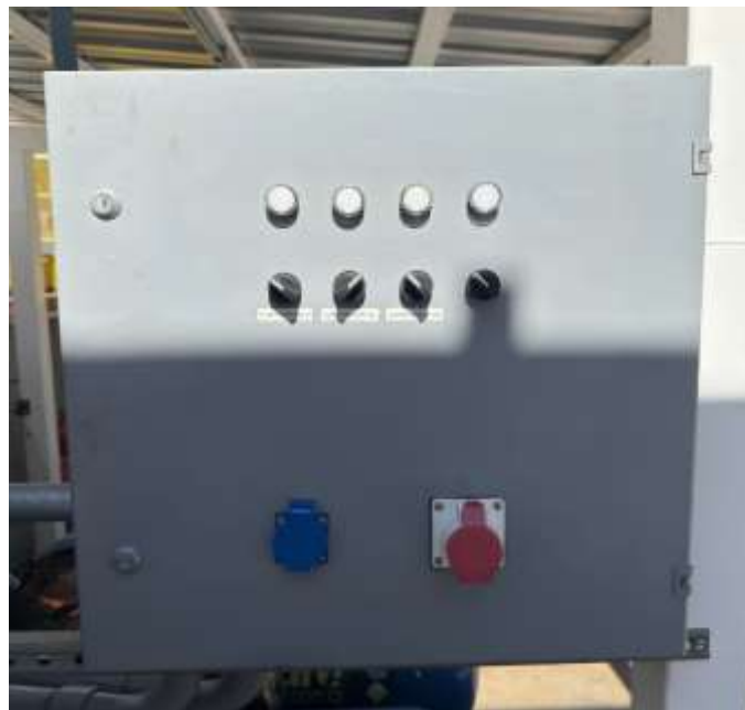
Figura 30 - Painel compressores - externo
