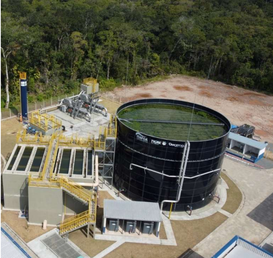
Figura 31 - Estação de Tratamento de Esgoto de Itapoá
