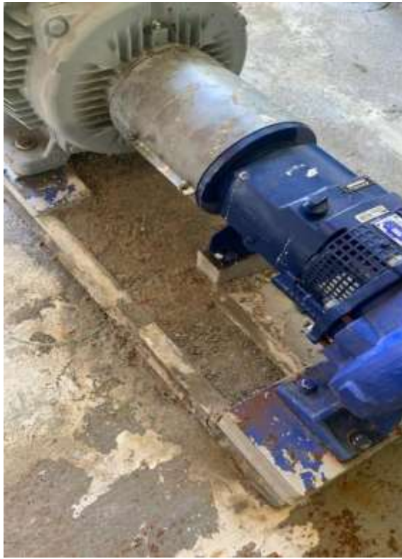
Figura 23 - Booster Barra, dois conjuntos motobomba de 100cv com graute
