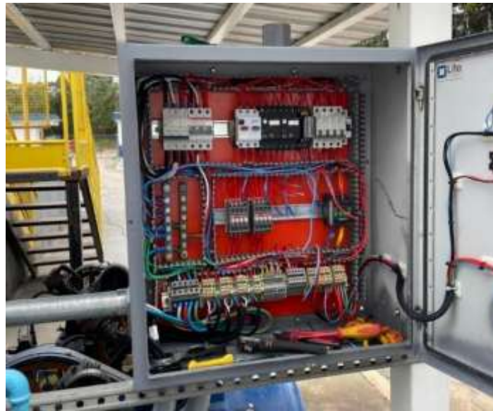
Figura 29 - Painel compressores - interno
