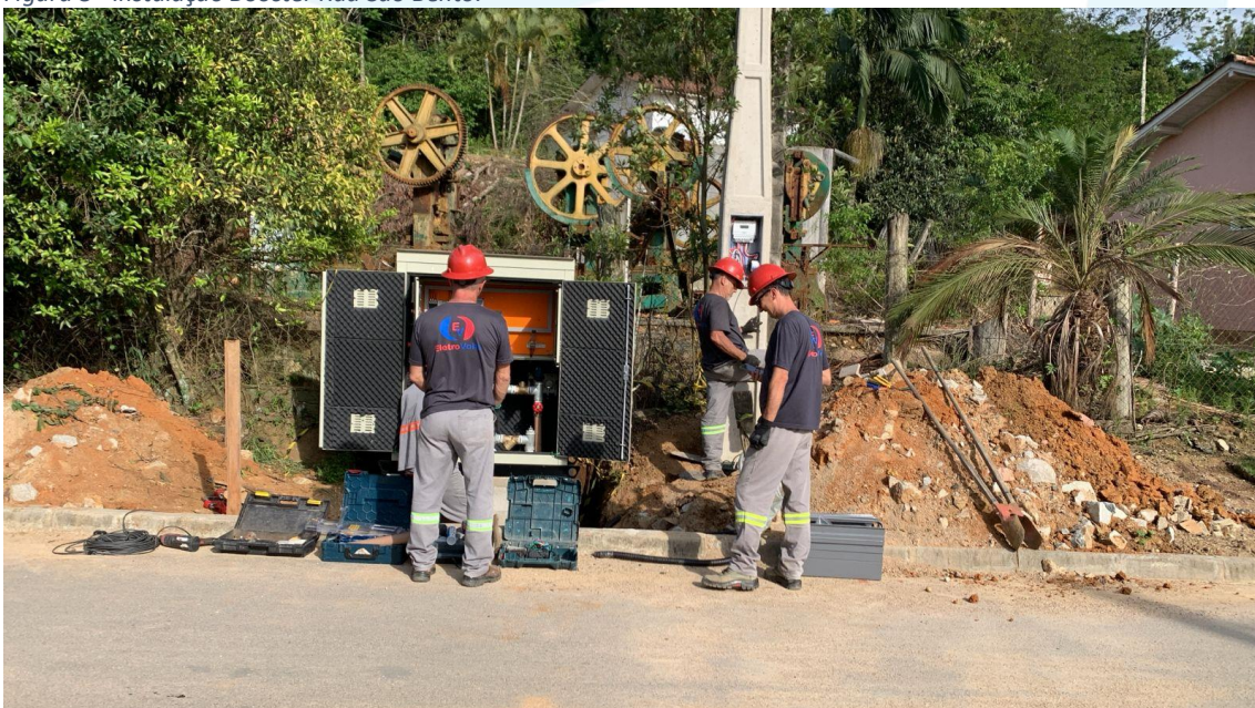
Figura 3 - Instalação Booster Rua São Bento.
